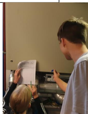
Ablesung des Wärmemengen-Zählers für die Energiebuchhaltung in der HLW Mureck
